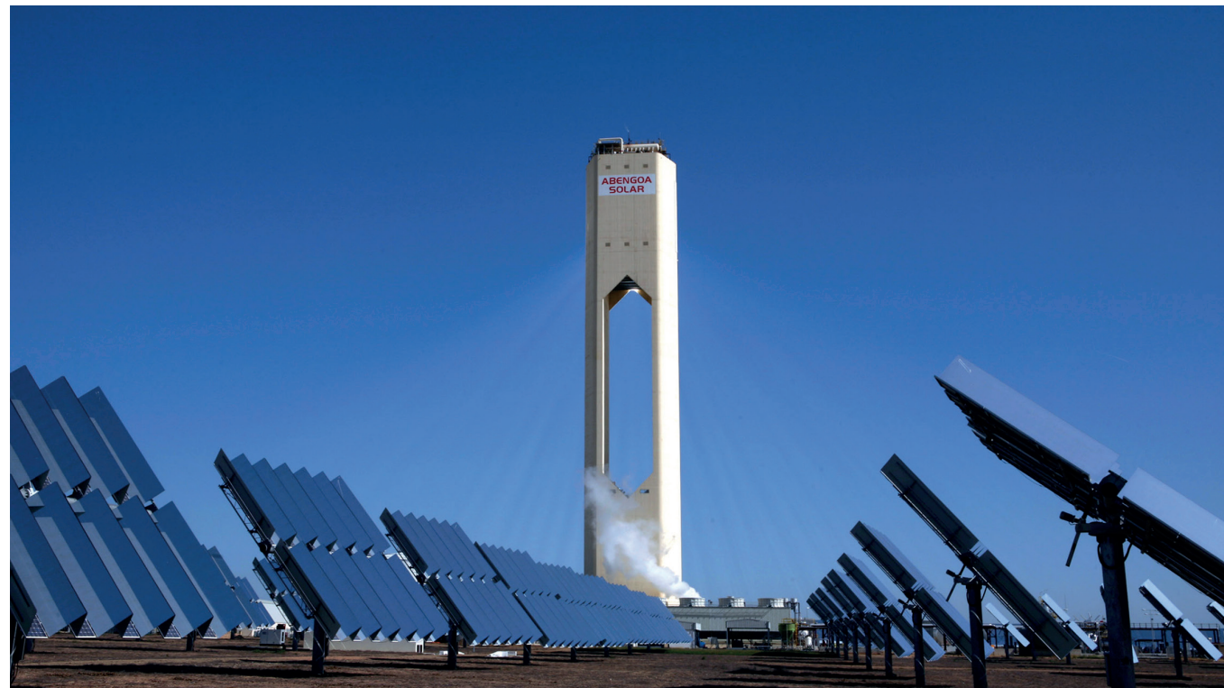
Figuur 6: Een CSP of concentrated solar power installatie in Andalusië (Spanje). CSP's zijn weinig gekende, maar krachtige opwekkers van duurzame elektriciteit.
